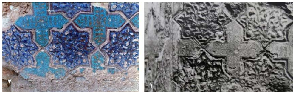
تصویر ۱۰: ۱. کاشی‌های زراندود مکشوفه ازارة ایوان بقعه سید رکن‌الدین در سال ۱۳۴۷ (اداره کل میراث‌فرهنگی تهران ۱۳۴۷)؛ ۲. همان کاشی‌ها در سال ۱۳۷۵ (اداره کل میراث‌فرهنگی یزد ۱۳۷۵)
