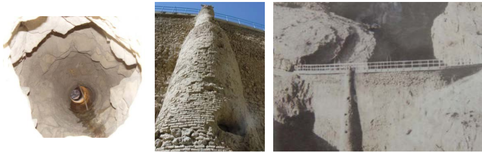
تصویر ۴: نماهای مختلف برج آبگیر از راست به چپ: نمای روبه‌روی برج از قسمت بالادست بدنه سد (مهندسین مشاور آب‌پوی ۱۳۷۸)؛ نمای برج آبگیر از پایین به بالا؛ دید به سمت پایین در برج آبگیر (جدارة سنگی داخلی)
