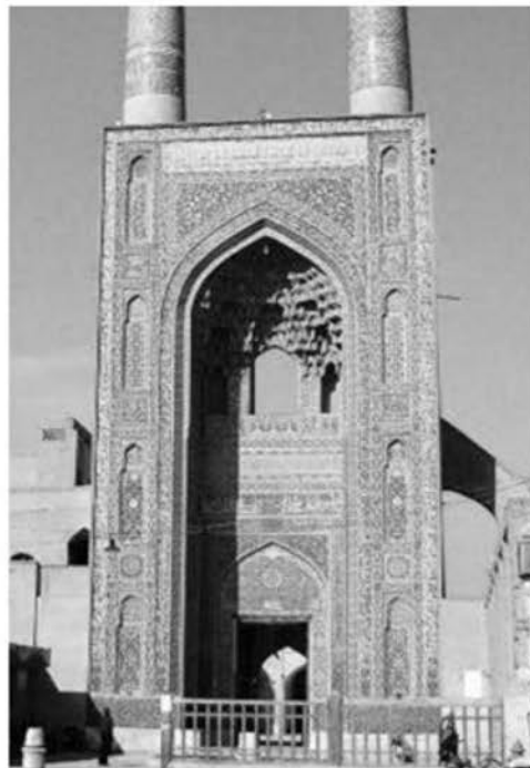
تصویر ۱۵: سردر شرقی مسجد جامع یزد پس از مرمت و تکمیل کاشی‌کاری سطوحی که اجرا نشده مانده بود.
