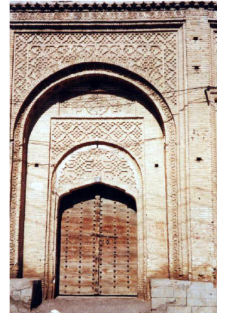
تصویر ۱۰: خانه زرگر محله قلعه شماره ثبت ۷۹۰۱. این ورودی به عنوان پرکارترین ورودی در بافت دزفول و ربوط به دوره قاجار می باشد.
